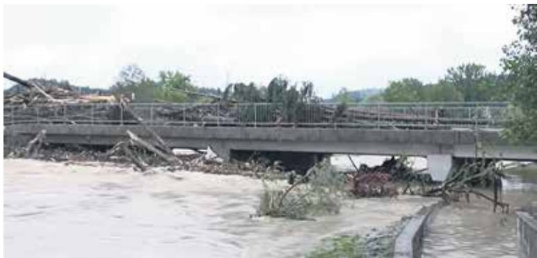
Poškodovani most avgusta 2023
